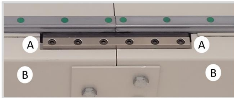
Figur 6. Steder, hvor der kan opstå revner
